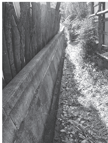
雨水と雑排水の排水溝（共同溝に放流）（図6-E）
