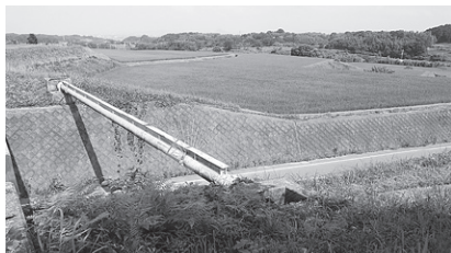
21／県道の上に渡したパイプの中を流れる北山水路
