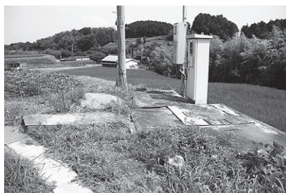
29／給水ポンプ場から送られてきた水を貯めるポンプ貯水場。ここから北山水路に揚水する
