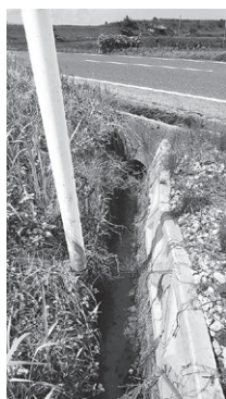
28／大倉水路の上を流れる県道脇の雨水側溝に、一番低い田の「ほかし水」が合流する
