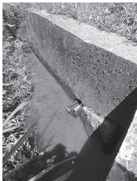
16／丸太の太さを調節して隙間を作り、配水量を加減している
