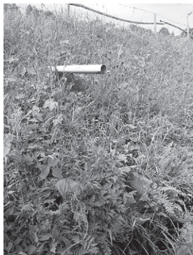
08／土手にパイプを通し、山手の田の水を北山水路（写真右下）に落とす
