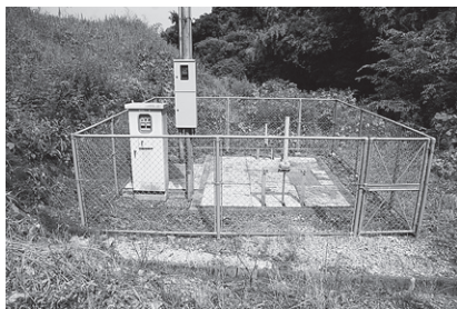
31／大倉川から水を引く吸水ポンプ場
